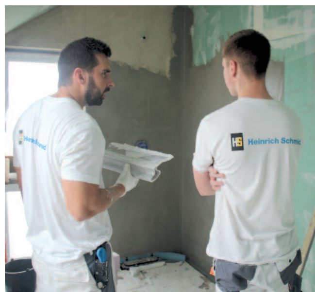
Praktische Baustellenausbildung: Wenn Daniel Tausch eine Frage hat, wird diese von Roman Letzgas gleich geklärt.
