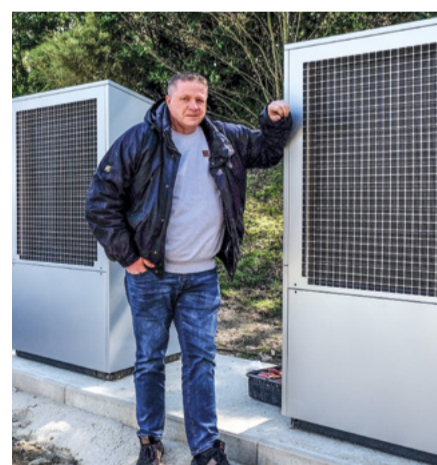
▲ Modern heizen: Alle Häuser der Siedlung erhalten zentrale Wärmepumpenanlagen.
