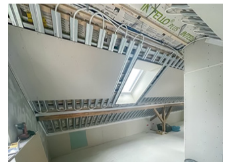
▲ Die Kühl-Heizdecke, eine technisch anspruchsvolle Konstruktion.
