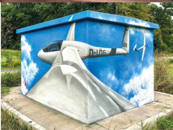
Nur Fliegen ist schöner: Trafostation im baden-württembergischen Löchgau. ▶
