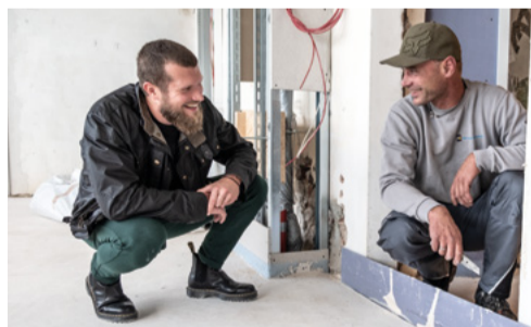
▲ Beim Niveaueingleich der Betondecken betrug der Höhenunterschied bis zu neun Zentimeter.
