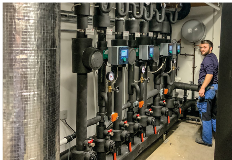
Der bauleitende Obermonteur Öner Vural im Rewe-Markt Ulm vor dem Verteiler der Wärme-/Kälteversorgung beim Einregulieren der Volumenströme und der Energiesparpumpen. Die Anlage bringt die optimal Energieeffizienz nur dann, wenn alle Anlagenkomponenten nach den errechneten Sollwerten richtig eingestellt und auch protokolliert sind.
