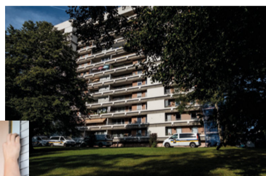
Die 16.000 Quadratmeter große Fassade des Wohnquartiers in Sindelfingen wird in zwei Bauabschnitten komplett saniert.
