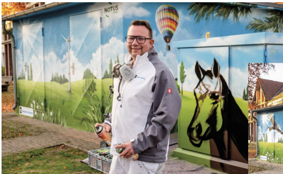
Landschaft aus der Dose: Im Spreewalddorf Schönwalde verpasste Marc Knust im Auftrag der Gemeinde einer alten Trafostation einen neuen Look.
