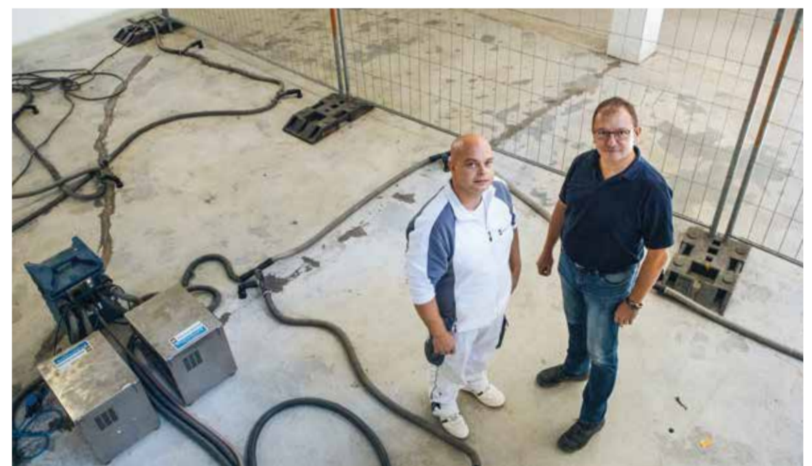
Schneller Eingreiftrupp: Rafael Müller (l.) und Andreas Kwoßek von der Offenburger Abteilung Bautrocknung rücken an, wenn durch undichte Fugen und Rohre oder durch Risse im Mauerwerk Feuchtigkeit in Häuser gekrochen ist – und bewahren diese damit vor irreparablen Schäden.
